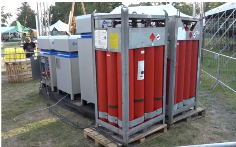
Obr. 58 - Mobilní instalace vodíkového generátoru
