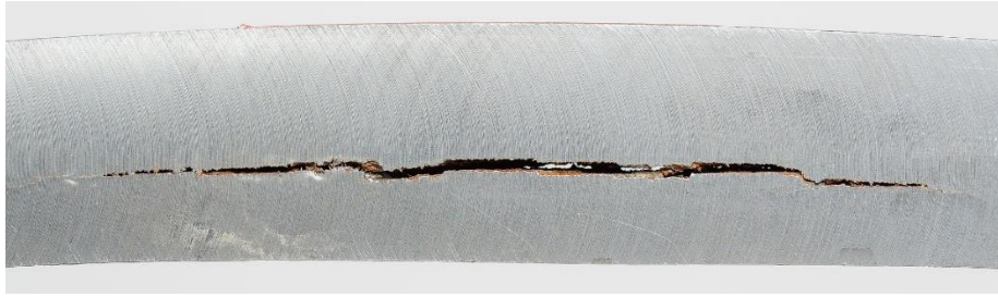
Obr. 23 - Materiál porušený vodíkovou korozí [7]
